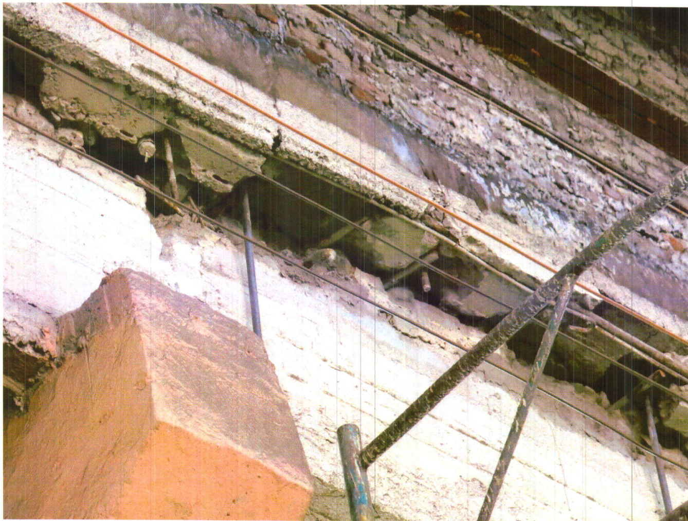
Рис. 1. Вертикальные трещины, сколы бетона в стенке и полке подкрановой балки.
